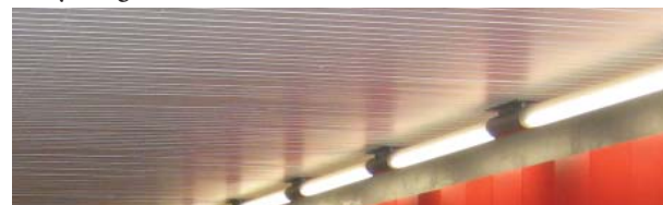
Belysning i tunnel, linjearmaturer
