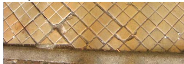
Belægning ujævn og slidt
